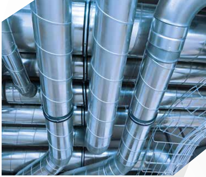
مسلزمات قنوات التكييف المركزي Air Conditioning Ducts
